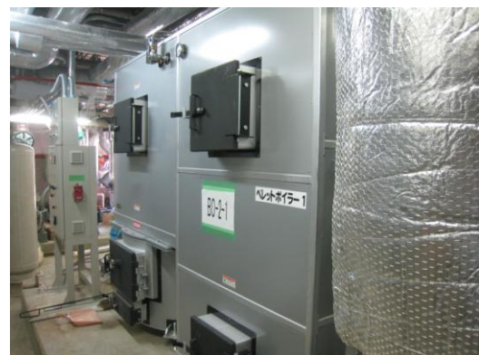
ペレットボイラー
